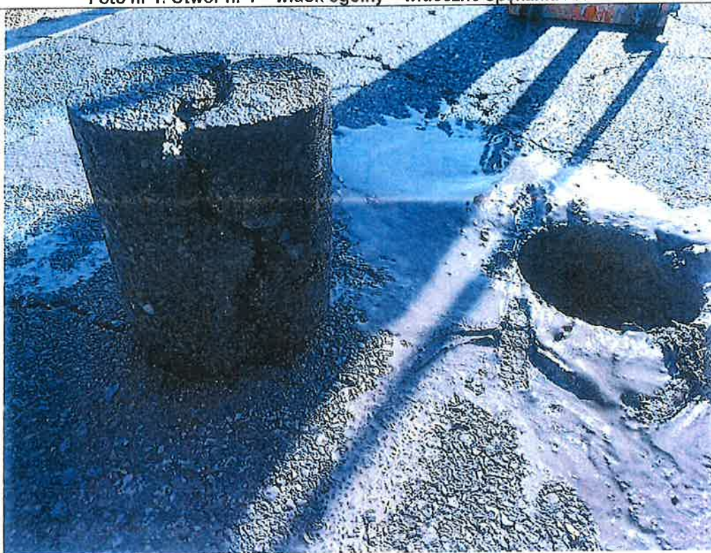
Foto nr 2. Otwór nr 1 – wycięty rdzeń z warstw asfaltowych z widocznym pęknięciem przez cały przekrój, rysa zwęża się ku dołowi
