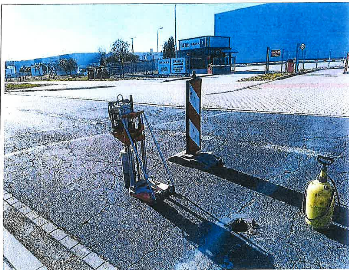
Foto nr 1. Otwór nr 1 – widok ogólny – widoczne spękania blokowe
