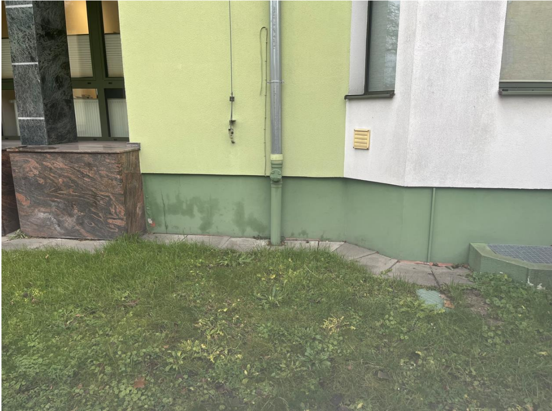
Fotografia 5 Zawilgocenie ścian zewnętrznych budynku.
