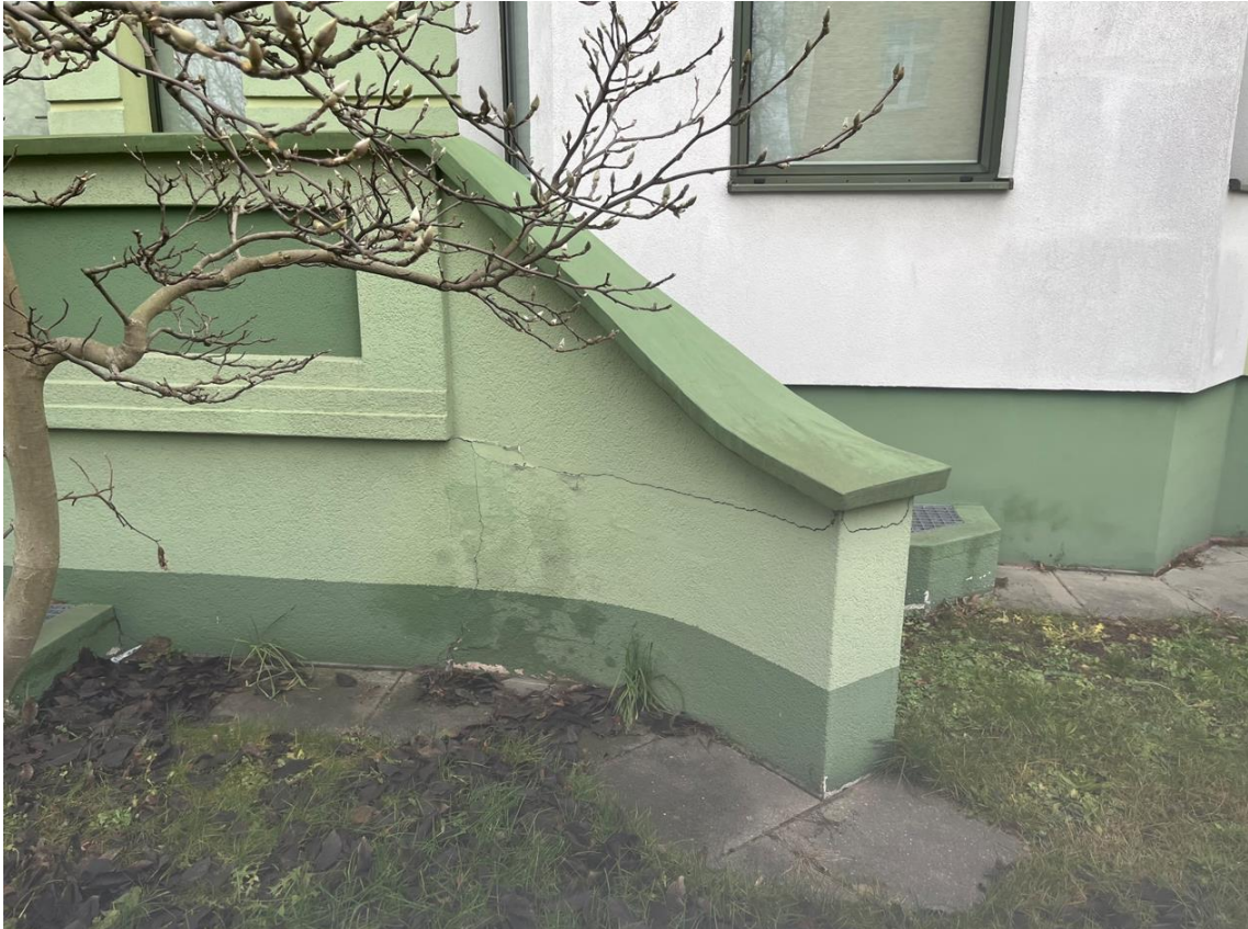
Fotografia 7 Zarysowania oraz zawilgocenia ścian zewnętrznych budynku.
