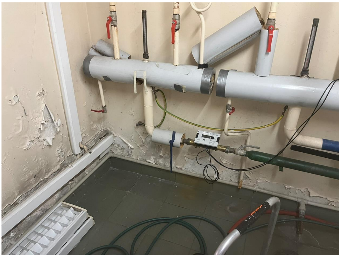
Fotografia 1 Odspojenie powłok malarskich oraz zmurszenie murów
