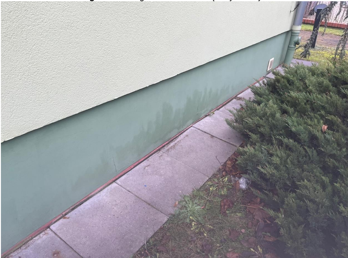
Fotografia 6 Zawilgocenie ścian zewnętrznych budynku.
