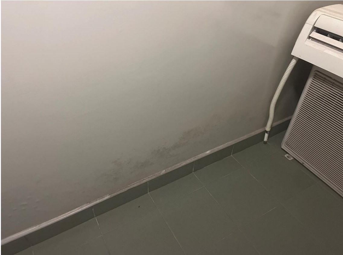
Fotografia 3 Zawilgocenie ścian wewnętrznych piwnic
