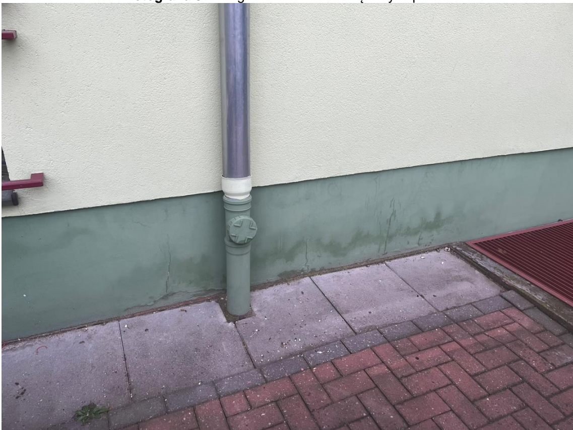
Fotografia 4 Zawilgocenie ścian zewnętrznych budynku.
