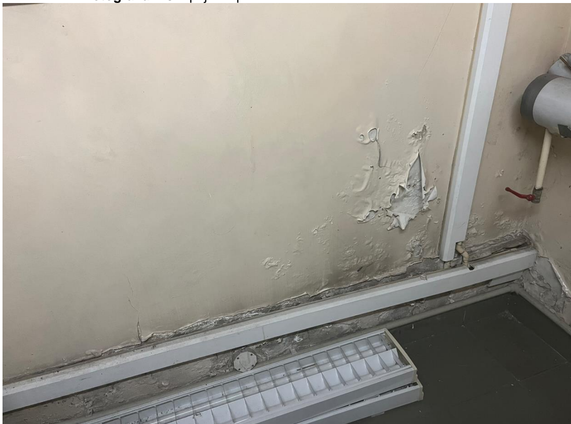
Fotografia 2 Odspojenie powłok malarskich oraz zmurszenie murów
